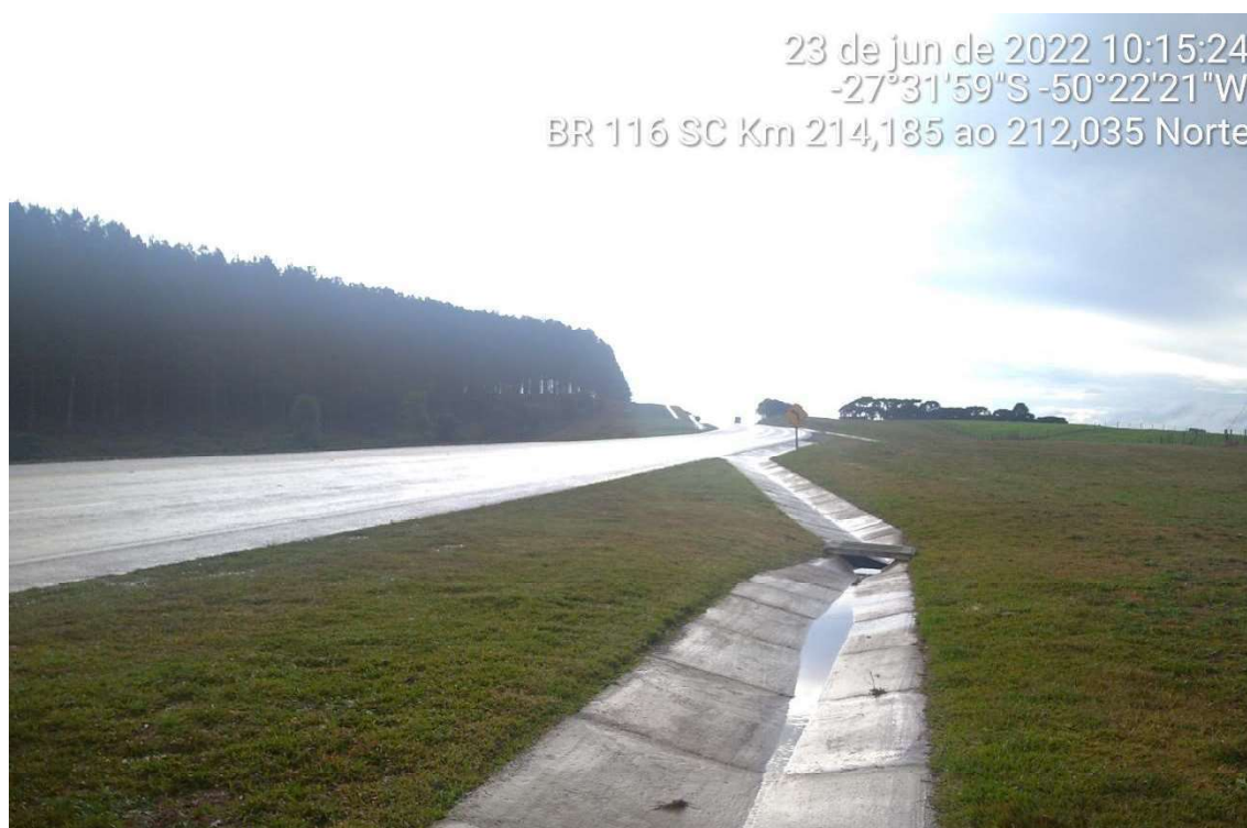
FIGURA 10-22 – DISPOSITIVO DE DRENAGEM E SINALIZAÇÃO VERTICAL
