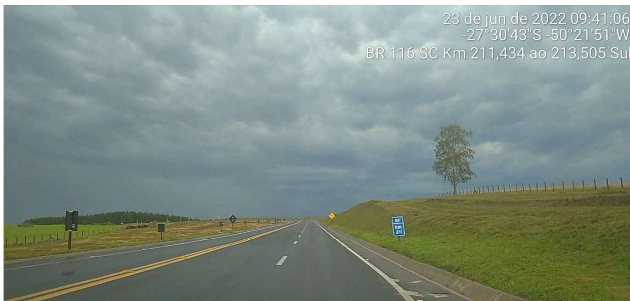
FIGURA 10.15 – SINALIZAÇÃO VERTICAL E HORIZONTAL E DISPOSITIVO DE DRENAGEM
