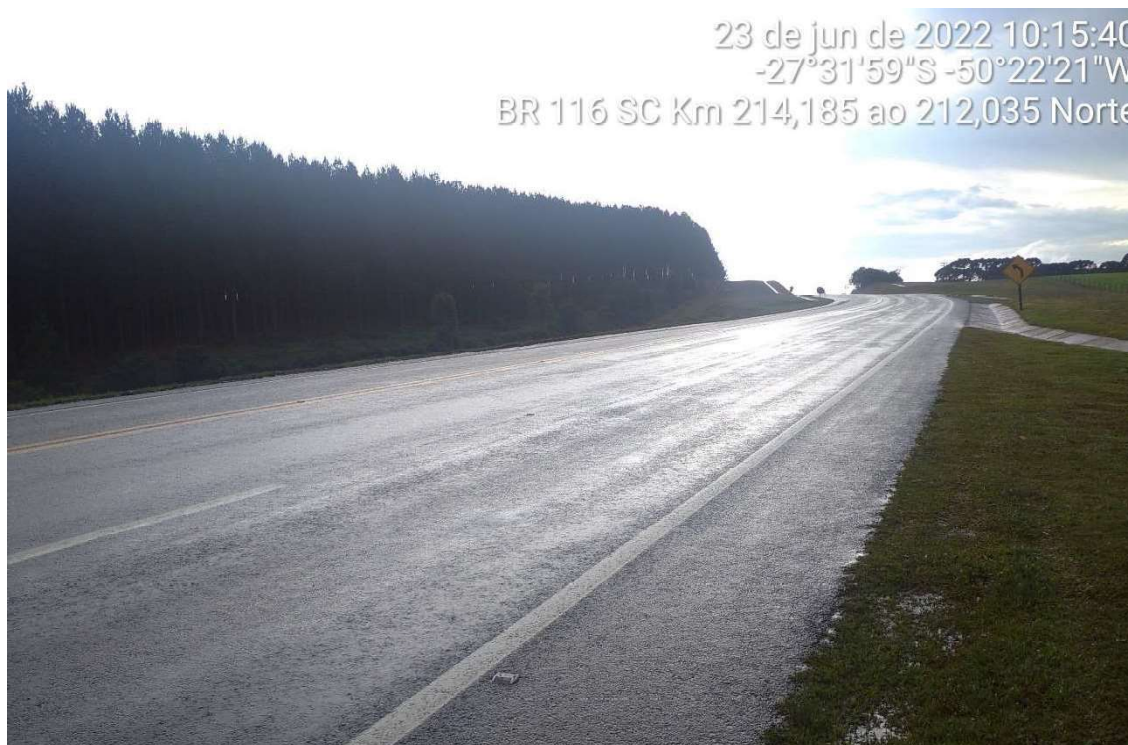
FIGURA 10-23 – SINALIZAÇÃO HORIZONTAL E VERTICAL
