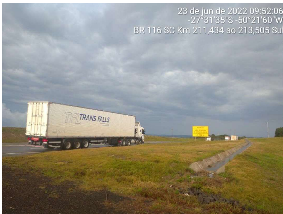
FIGURA 10.13 – DISPOSITIVO DE DRENAGEM E SINALIZAÇÃO VERTICAL
