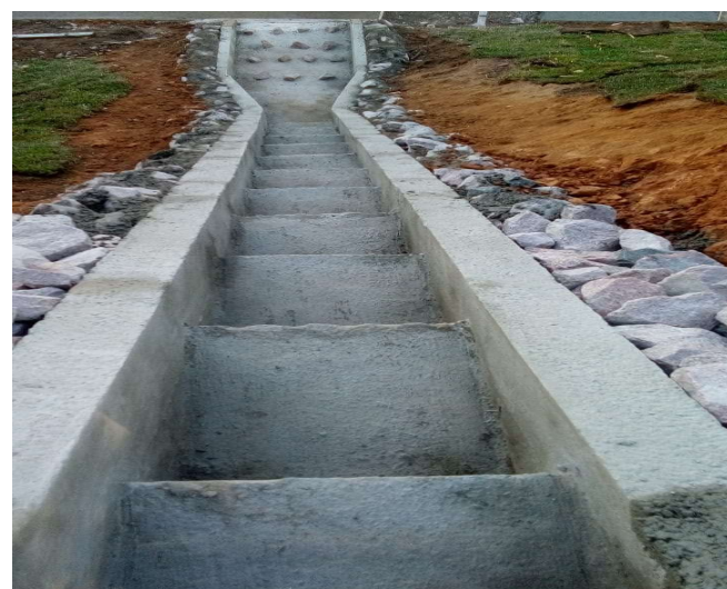
Figura 5.17 – Dispositivos de drenagem.
