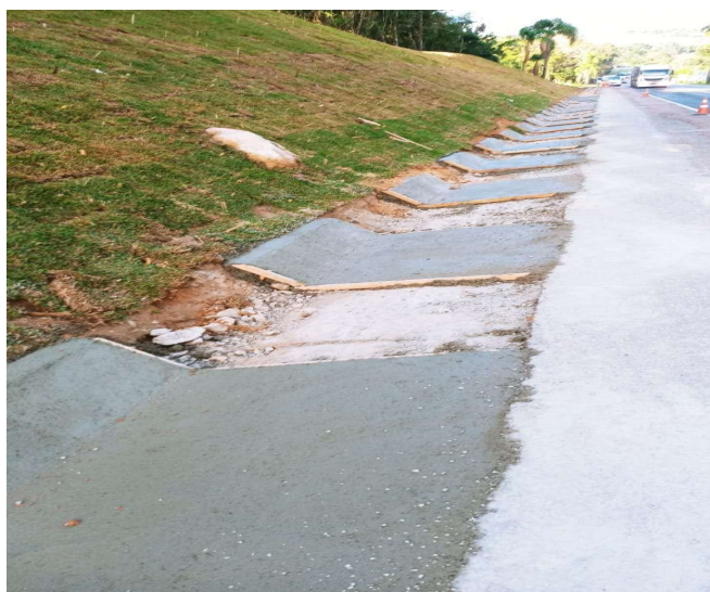
Figura 5.15 – Dispositivos de drenagem.
