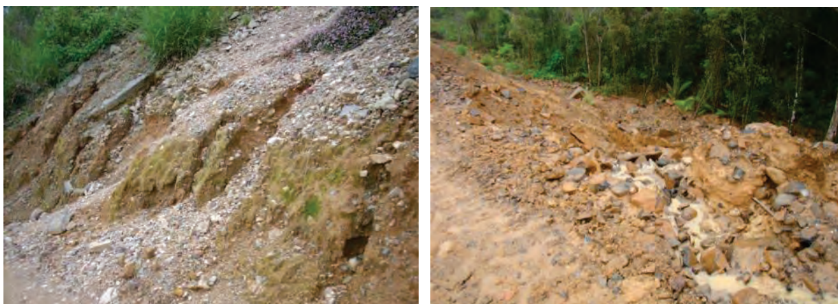
Figura 2: Instabilidade de talude de aterro associado a não implantação de drenagem e proteção superficial.
