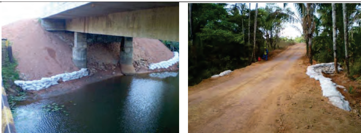
Figura 7: Dispositivo de proteção ambiental – Rip-Rap.
