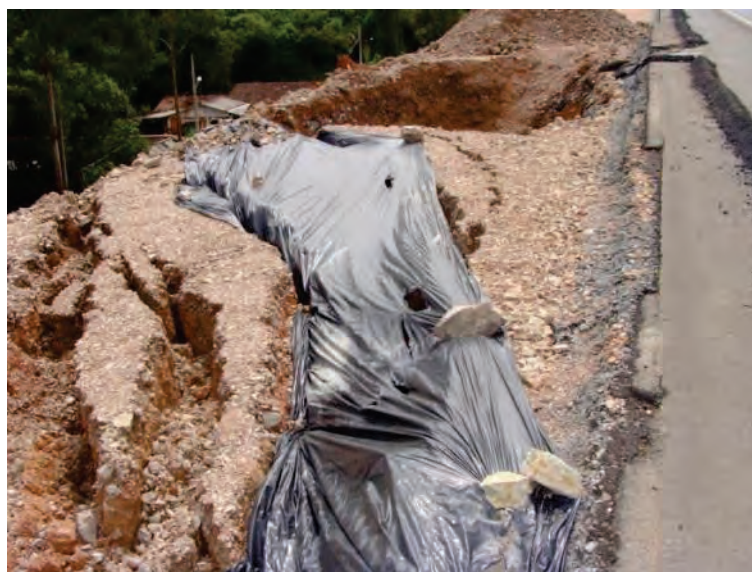
Figura 3: Instabilidade de talude de aterro associado a não implantação de drenagem e proteção superficial.
