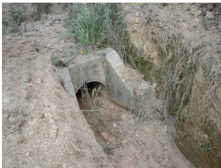
Figura 5: Entupimento parcial de drenagem.
