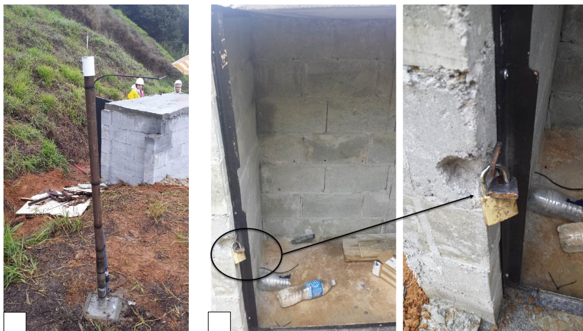
Figura 50 – Situação em campo após ocorrência de atos de vandalismo: (a) haste onde o pluviôgrafo estava fixado e (b) casa de leituras após o furto
