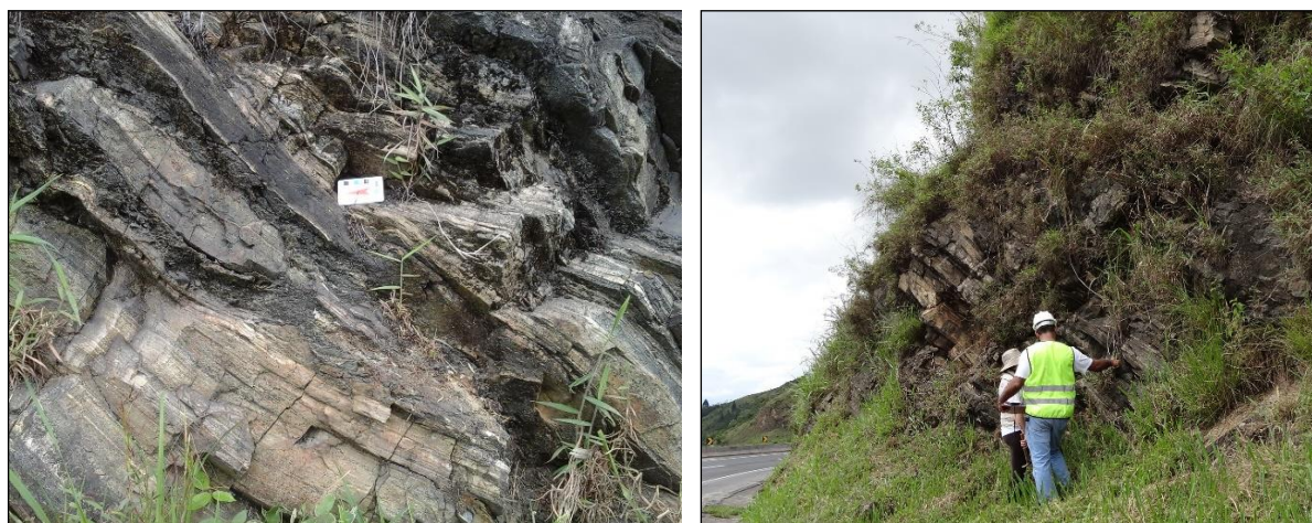
Figura 9 - Talude do km 511+640 PN: mapeamento de rocha do tipo Paragneisse onde o bandamento do gnaiss pode dar origem a taludes negativos
