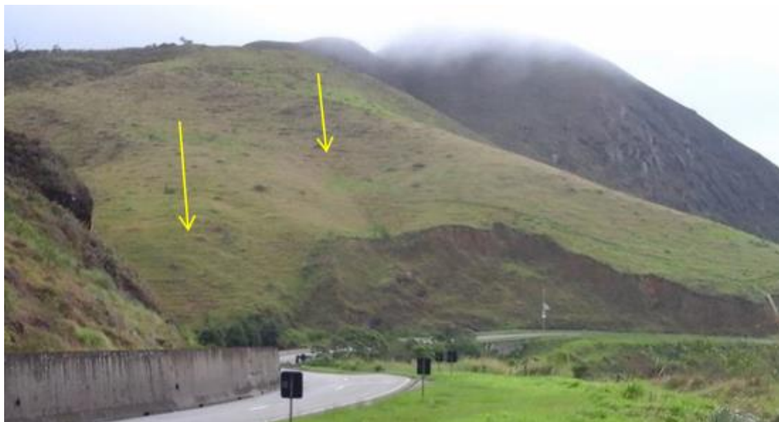
Figura 8 - Disposição irregular da camada de solo além de indícios de escorregamentos antigos no km 550+140 PN, assinalados com flechas amarelas
