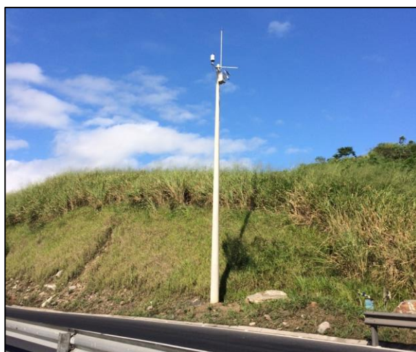
Figura 62 - Poste com pluviógrafo instalado no km P 508+700 PS
