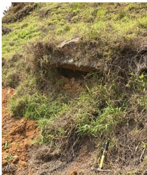
Figura 29 - Fenda de movimentação do solo sob galeria de drenagem
