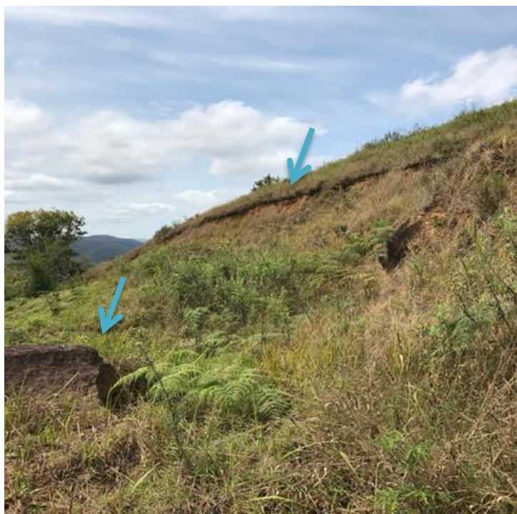
Figura 32 – Cicatrizes de deslizamento pretérito à montante do talude km P552+000 PN
