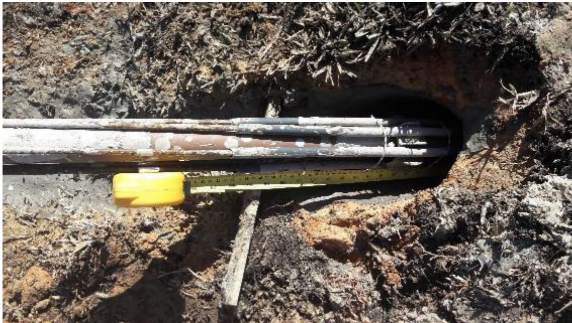
Figura 94 - Falha com ar no início do furo do tirante de fio
