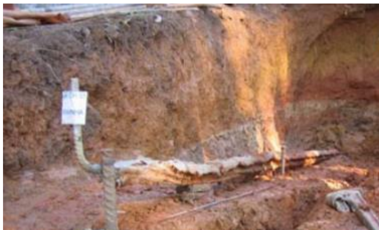
Figura 2 – Chumbador parcialmente escavado com vazios
