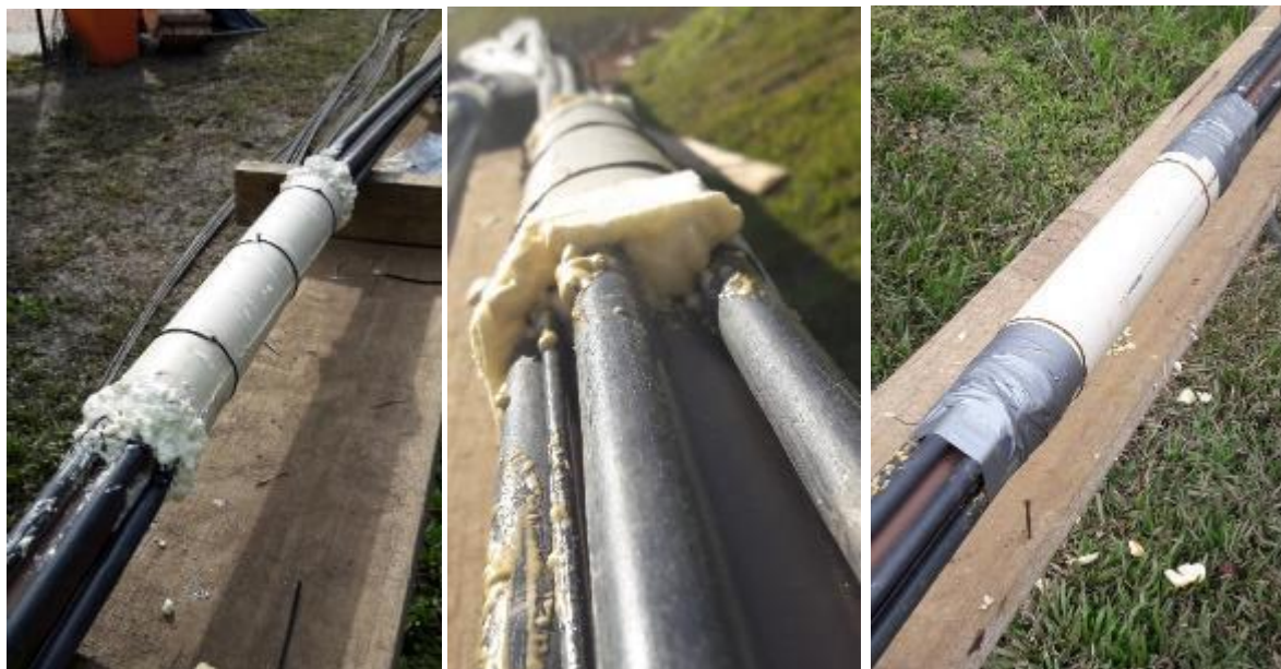
Figura 90 – Falha com ar nas cordoalhas
