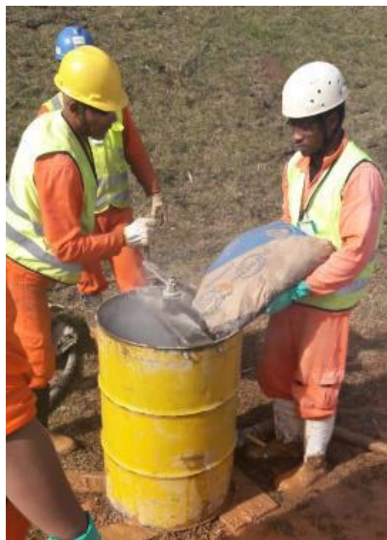
Figura 73 – Misturador manual da calda de cimento
